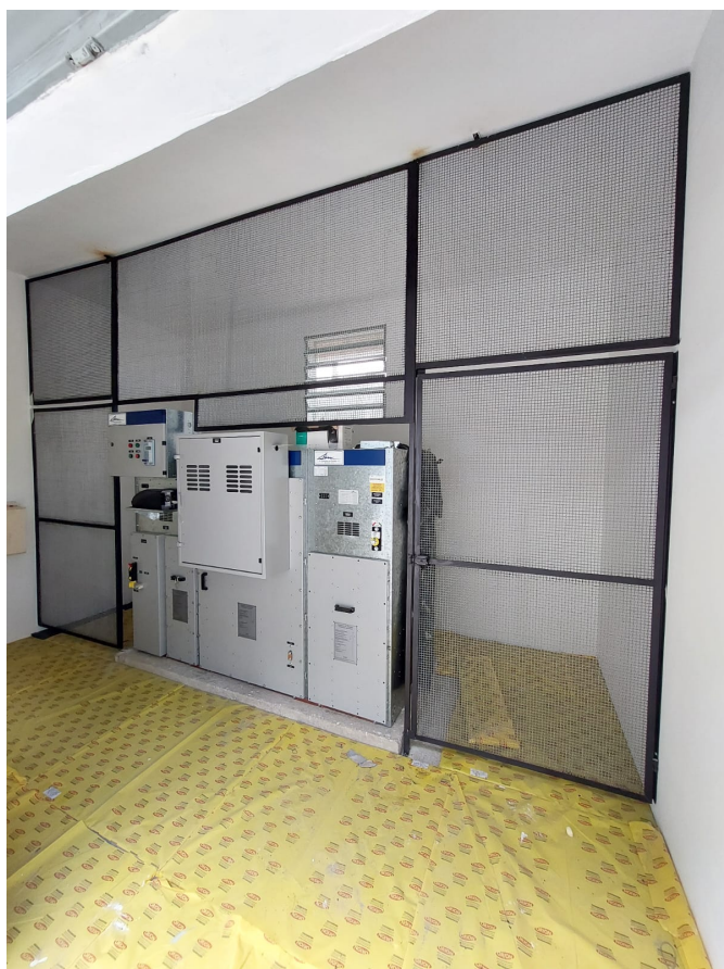
Imagem: Cubículos instalados
